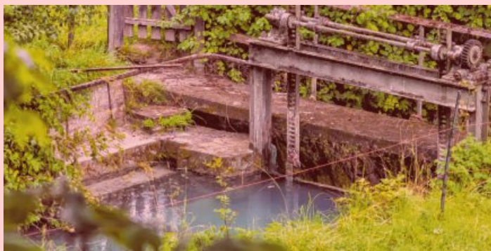
Das Kraftwerk Mieming wird u. a. mit dem Wasser aus dem Krebsbach (hier im Bild) und dem Lehnbach gespeist.
