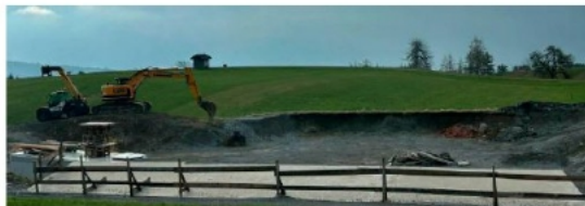
Der Bauwerber hatte mit den Arbeiten bereits begonnen. Jetzt wird er vermutlich den ursprünglichen Zustand wieder herstellen müssen. Foto: privat
