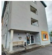
Die Notschlafstelle in Arzl muss saniert werden.
