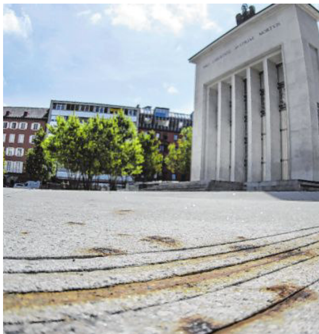
Die rostigen Flecken mussten wieder einmal saniert werden, aber jetzt traten erneut Rissbildungen auf.
